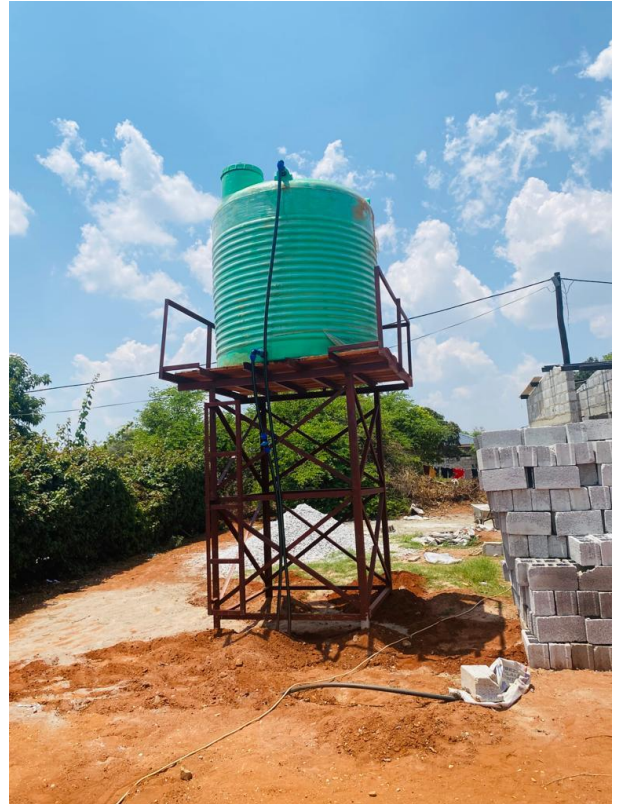
Verhoogde wateropslag tanks (5000 liter) bij Chinda geopend.
